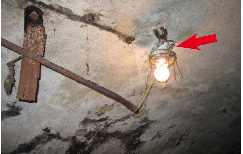
Mangelnder Unterhalt in Keller
